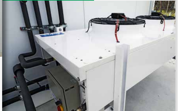
Gaskühler zur Abfuhr der Restwärme.
