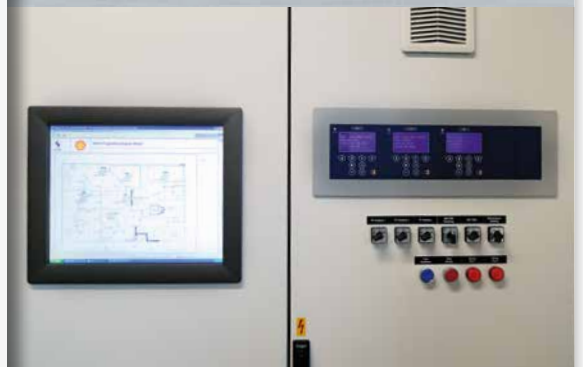
Schaltschrank mit Leitsystem und Fernüberwachung.
