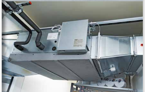
Lüftungsmonobloc zum Heizen und Klimatisieren des Shops.
